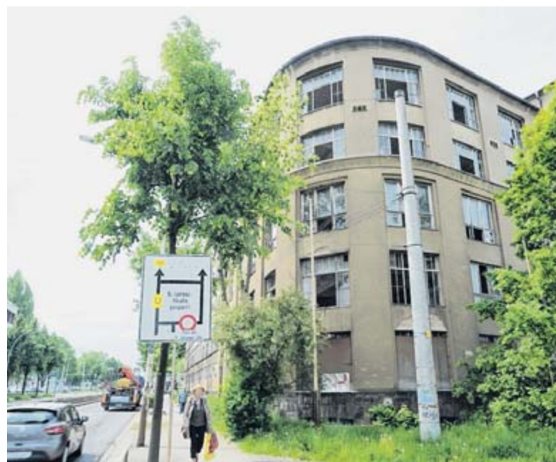
Der ehemalige Sitz der Sächsischen Nadel- und Platinenfabrik (Naplafa) an der Annaberger Straße/Ecke Waplerstraße. Weil dann Gebäudeteile abzustürzen drohen, wird der Gehweg bei Sturm gesperrt. FOTO: ANDREAS SEIDEL
